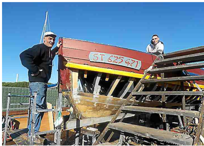
Après quatre mois de travaux, la fin du chantier est prévue fin février.
